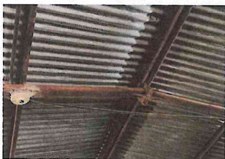
Foto 1: Estructura oxidada y lámina en mal estado
