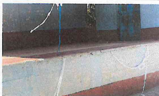
Foto 4: Pintura general en malas condiciones
