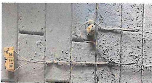
Foto 5: Tomacorrientes y apagadores en mal estado
