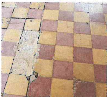
Foto 3: Piso en mal estado
