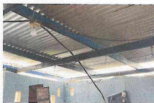
Foto 2: Cableado eléctrico en mal estado
